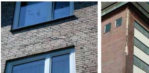
Abbildung 3: Ein Schadensbild für eine unzureichende Verbindung von Verblend- zu Tragschale kann ein Beulen der Verblendschale oder ein typisches Rissbild auf der Fassade sein. Ein Versagen tritt über herabfallende Ziegel oder ganze Fassadenteile auf.
