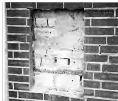
Abbildung 4: Die Abbildung aus dem Sonderdruck für Fassadentechnik 2/2000 Seite 2, Abb. 2. Hier ist die „Öffnung zur Begutachtung des tragenden Untergrundes“ und der möglicherweise vorhandenen Drahtanker sichtbar. Das zweischalige Mauerwerk ist mit einer Schalenfuge aufgebaut.
