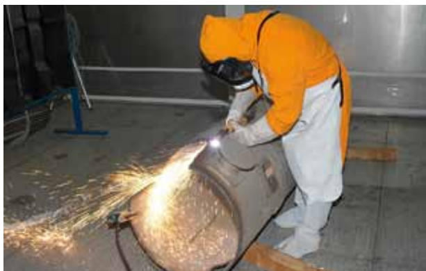
Reststoffbehandlung in einem speziell ausgerüsteten Dekontaminationscaisson
