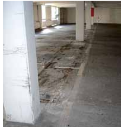
Abb. 1: Foto eines großflächig geschädigten Parkhauses [Quelle: IGF Ingenieurgesellschaft]
