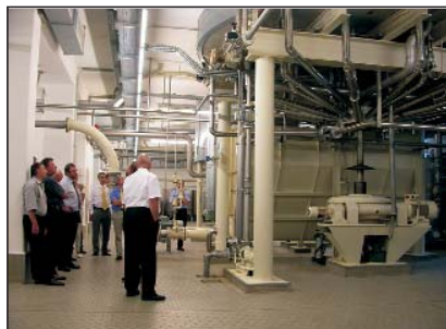
Rohrleitungen im Sudhaus
