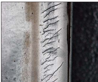
Bild 1: Head Check-Anzeigen einer MP-Prüfung
