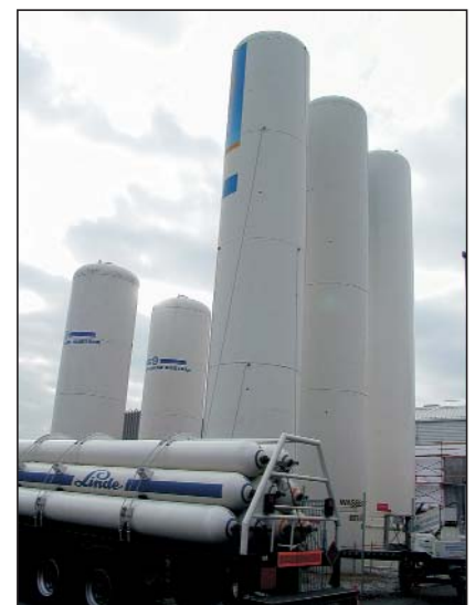
Überwachung einer wiederkehrenden Überprüfung an 3 H 2 -Behältern mittels Schallemission im Zuge einer Gasdruckprüfung
