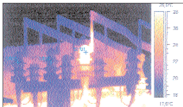
Bild 4: Thermographie-Bild der oben dargestellten Umspannungsanlage
