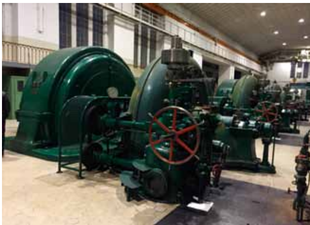
Fünf Francis Spiralturbinen arbeiten im Murgwerk
