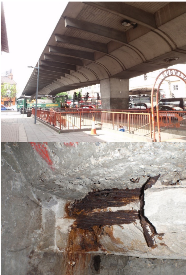
Abb. 18: Ansicht der Hammersmith Flyover Brücke in London (Bild oben) mit Blick auf korrodierte Spanndrähte im Inneren der Brücke (Bild unten).
