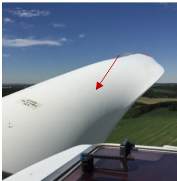
Abb. 37: Reparaturstelle am Rotorblatt
