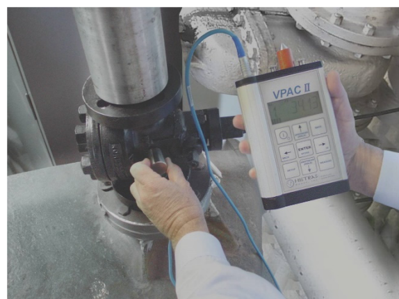
Abb. 8: Prüfung eines Ventils auf innere Leckage mit dem VPAC II- System VPAC II.
