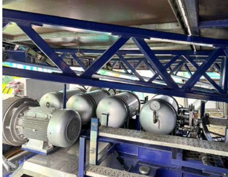
Unterkonstruktion mit Schweißnähten/ pneumatische Speicher
