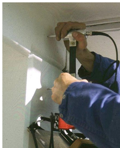
Abb. 1: In der Arbeitsfuge dieses Balkenfertigteils wird eine Hohlstelle vermutet. Transmitter und Empfänger werden so plaziert, daß sie diesen Bereich übergreifen.
